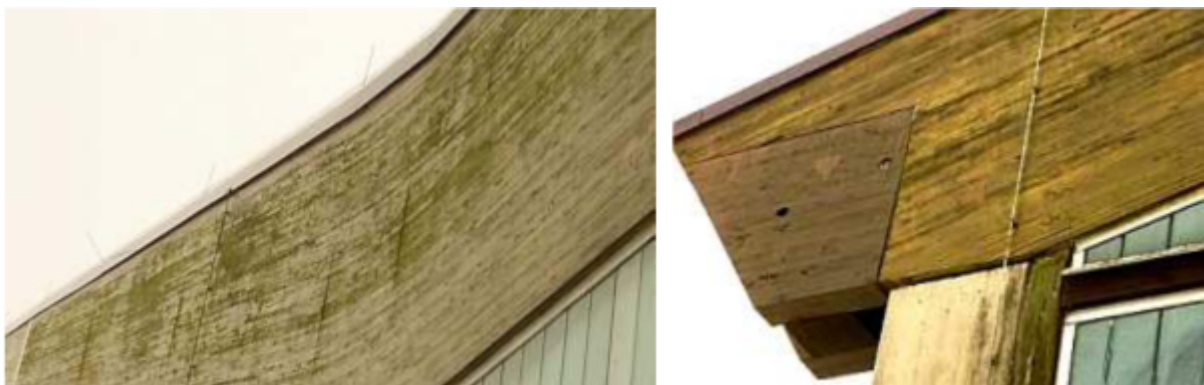
Abb. 1: abgewitterte Randträger; Veralgungen und zu erneuernder Anstrich
