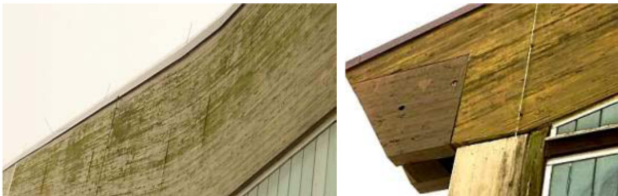
Abb. 1: abgewitterte Randträger; Veralgungen und zu erneuernder Anstrich
