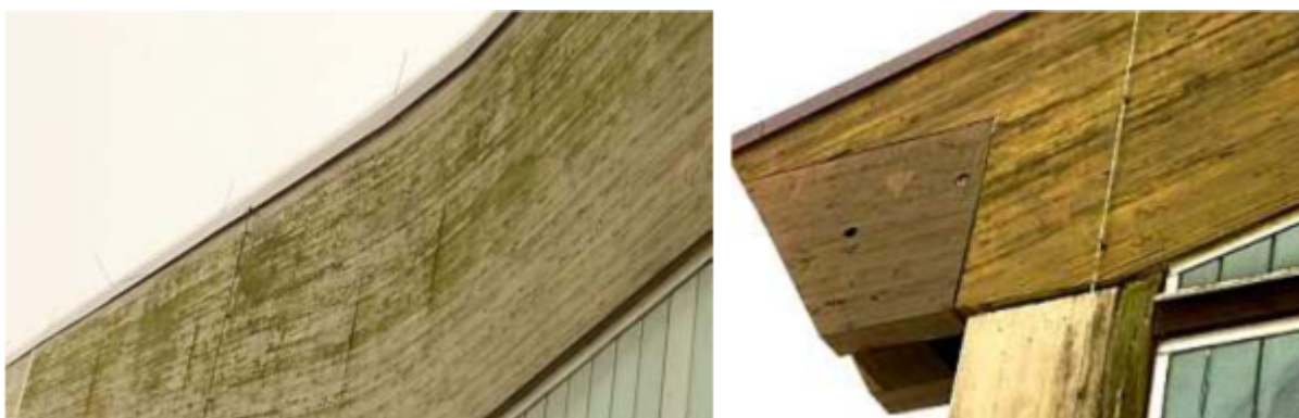
Abb. 1: abgewitterte Randträger; Veralgungen und zu erneuernder Anstrich
